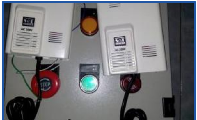
TỦ ĐIỆN AN TOÀN GAS
